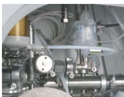
Diaphragm valve in AISI 316 L stainless steel with pneumatic actuator & decontamination of exhaust air with sterile filter / Valvola a membrana in acciaio AISI 316 L con attuatore pneumatico e decontaminazione dell'aria di scarico con filtro sterile
