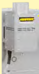
Chimney with fan
